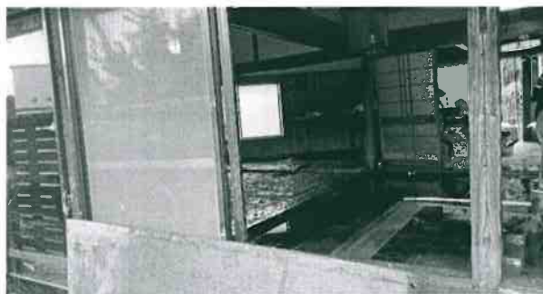
床上浸水被害の様子
